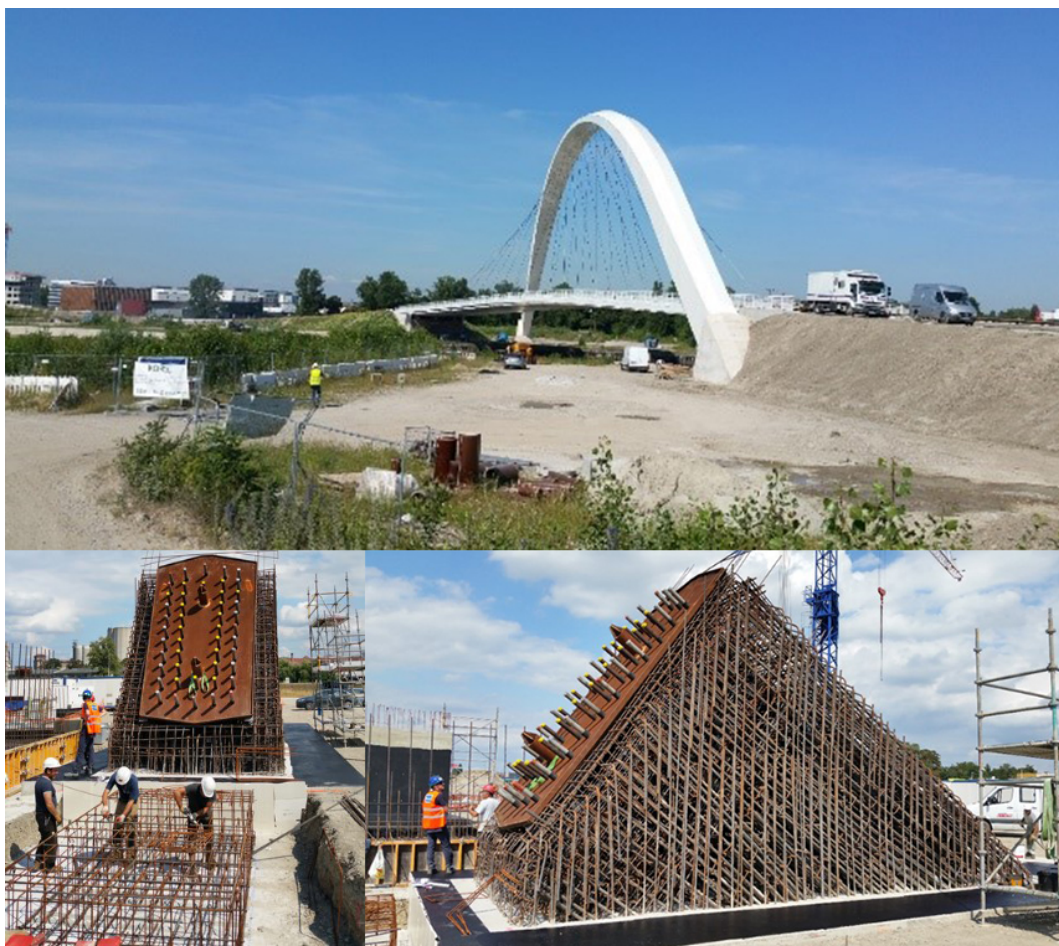
Massif d'ancrage du pont Citadelle à Strasbourg : platine d'ancrage 5,5 m x 2,6m – Ep 80 mm – Acier S460
