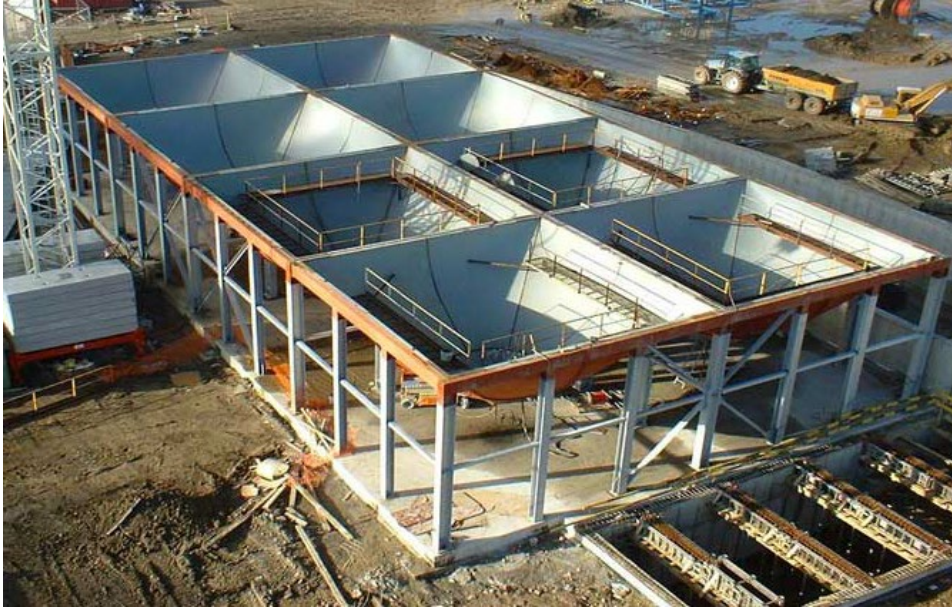
Silo rectangulaire en construction : les trémies sur structure support sont en place. ©Gillouaye SAS
