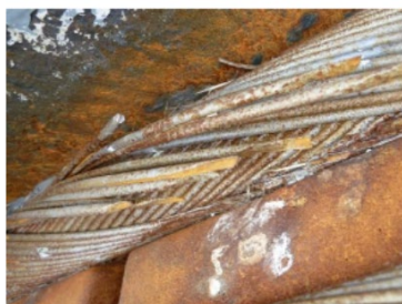
Rupture des fils d'un câble toronné par corrosion [5]
